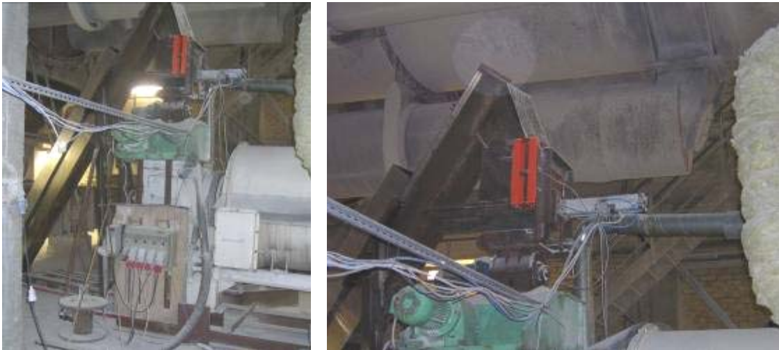
Bild 5,6: Släckarens inmatningsände med elevator som transporterade upp till satsvåg (röd) under vilken fanns cellmatare till kvarn (grön).
