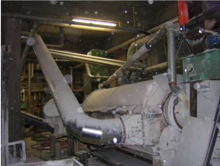
Bild 3: Utloppsledning från mantelkylning.
