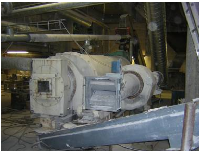
Bild 2: Släckare med kylfläkt och utmatningsskruv.
