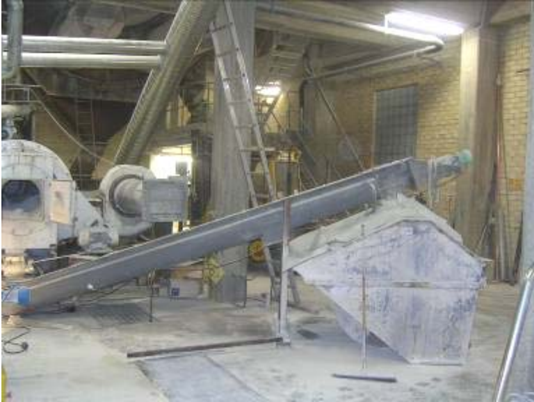
Bild 8: Släckarens kalkutmatning via cellmatare och skruvtransportör till container.
